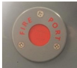
Feuerlöschöffnung auf der Backbordseite der Konsole
